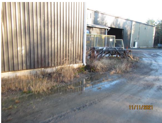
Kuva 7. Vesiä lammikoituu rakennuksen vierustalle.
