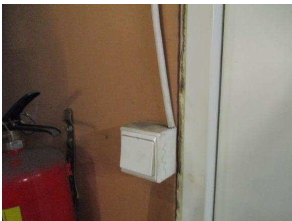
Kuva 93. Kaapelin kiinnitys heikko, irti.
