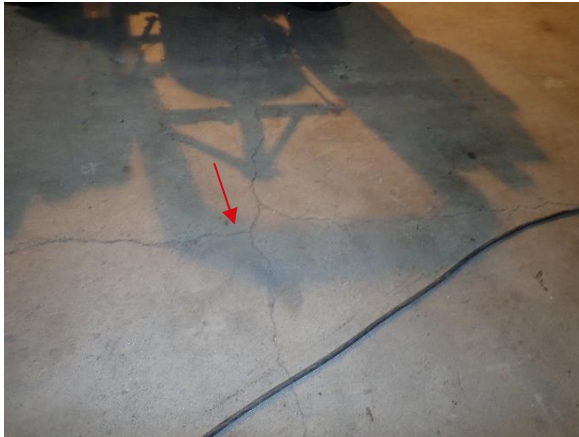
Kuva 14. Vanhan hallin lattiassa halkeilua
