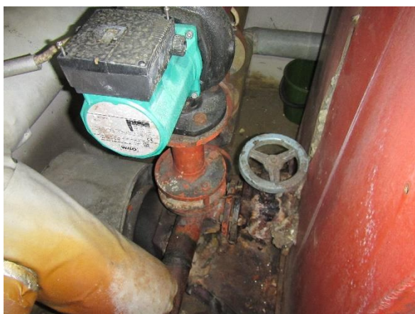
Kuva 65. Öljylämmitysjärjestelmän lämmönjakohuoneessa havaittiin huonokuntoisia venttiilejä. Kaikkien laitteiden käytössä olosta ei ollut tietoa.
