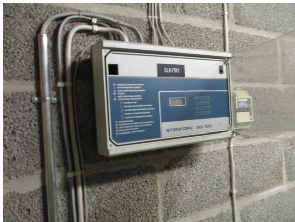
Kuva 123. Käytöstä poistuneita laitteistoja.
