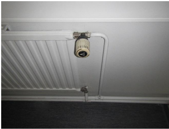
Kuva 71. Alkuperäinen radiaattori, patteriventtiili ja termostaattiosia toimistotiloissa.
