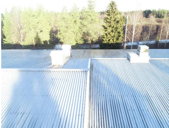
Kuva 39. Yleiskuvaa vesikatolta. Katolla vaikuttaisi paikoin olevan ruostelaikkuja, ei kuitenkaan laaja-alaisesti.
