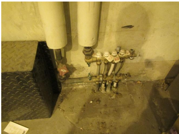
Kuva 67. Lattialämmityksen jakotukki ja lämpöjohtoja.
