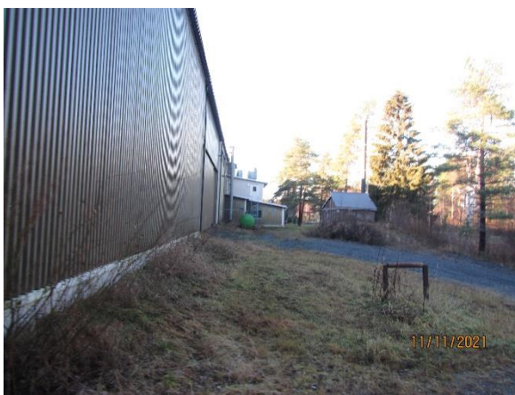
Kuva 4. Yleiskuvaa vanhemman hallin takapihalta, kasvillisuutta rakennuksen seinustassa kiinni
