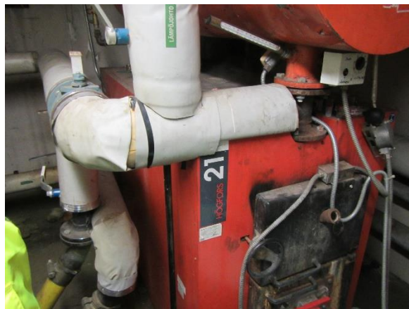
Kuva 64. Varalämmitysjärjestelmänä toimivaa öljylämmityslaitteistoa.
