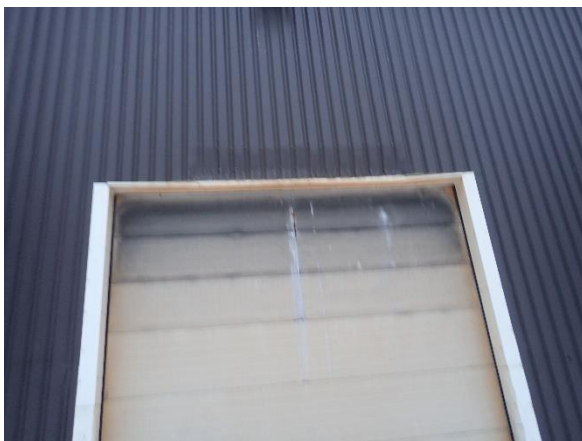
Kuva 27. Uuden hallin oven yläpuolen pellitys rutussa
