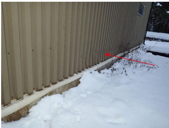
Kuva 23. Vanhan hallin julkisivupellityksissä on ruttuja
