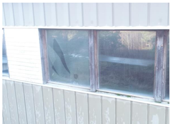
Kuva 31. Keltaisen hallin kohdalla ikkunoissa on haristumaa ja yksi ikkuna on rikki.
