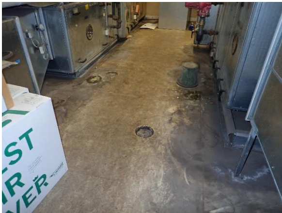
Kuva 59. Toimistorakennuksen päällä sijaitseva IV-konehuone
