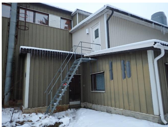
Kuva 26. Toimistorakennuksen katolla IV-konehuone
