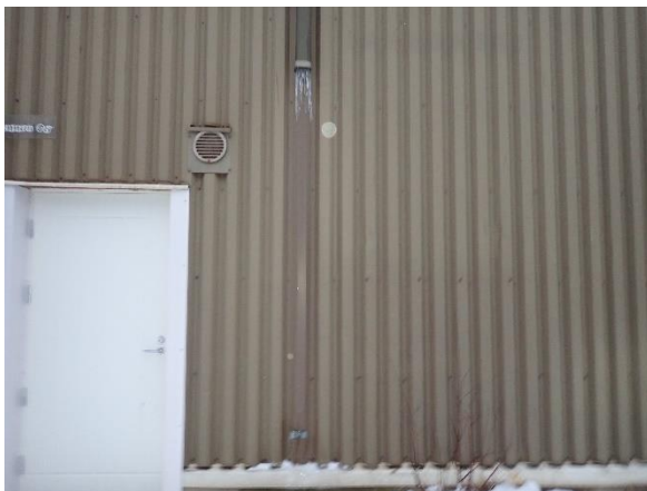
Kuva 43. Vanhemman hallin etupihan puolella syöksystä puuttuu pätkä.
