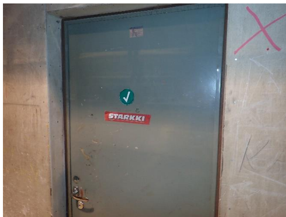
Kuva 44. Hallin ja toimiston välinen palo-ovi.
