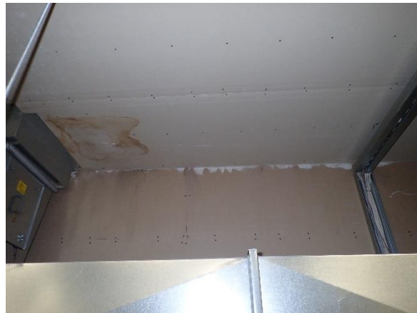
Kuva 60. IV-konehuoneen sisäkatossa on kuivunut kosteus läiskä
