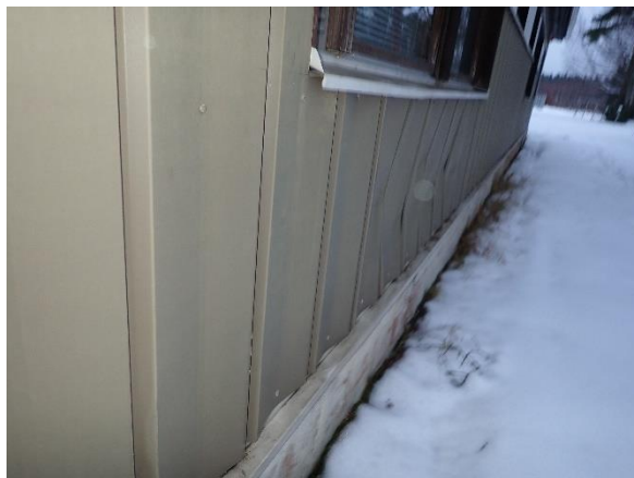
Kuva 24. Toimistorakennuksen ulkoseinä pellit on osin rutussa
