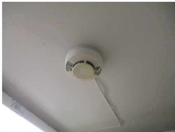
Kuva 120. Turvajärjestelmiin yhdistetty palovaroin.
