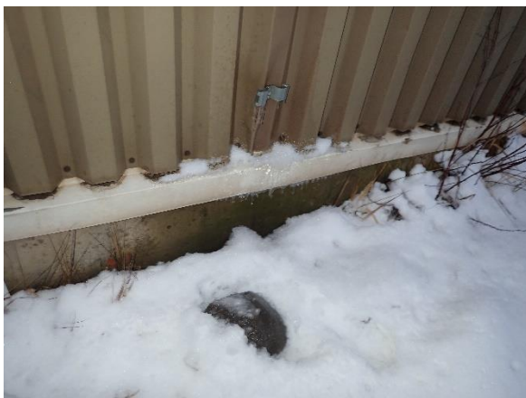
Kuva 13. Vanhemman hallin etupihan puolella katolta valunut vesi kastellut sokkelia
