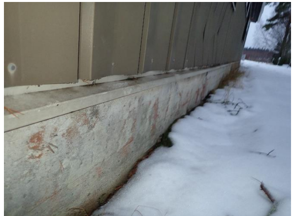
Kuva 12. Toimistorakennukset perustuksissa on rapaamaa
