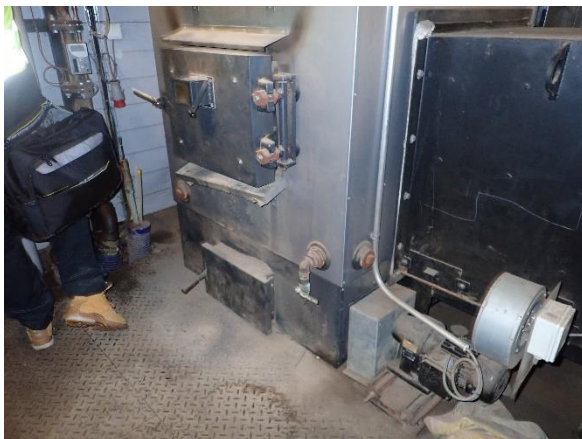
Kuva 57. Lämmönjakohuone on käyttötarkoituksensa mukaisessa kunnossa
