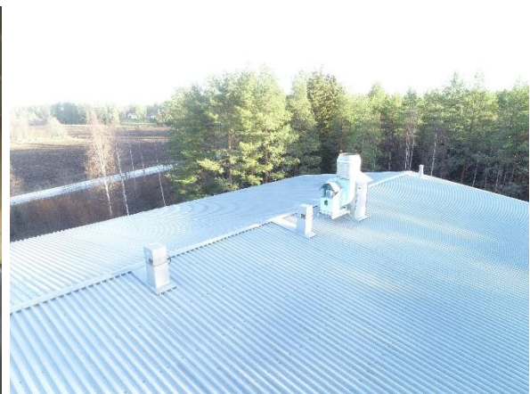
Kuva 80. Huippumureita ja poistopuhallin vesikatolla.
