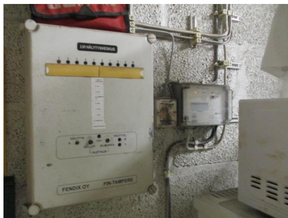
Kuva 122. Öljyerotuskaivon hälytysvalvontalaite ja vanhempi hälytinlaitteisto.
