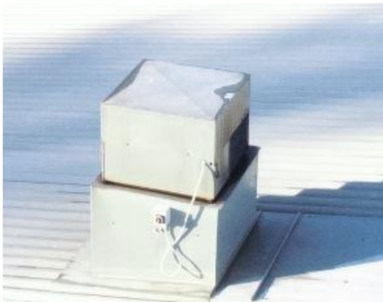
Kuva 99. LVI-laitteiston sähköistyksiä katolla.
